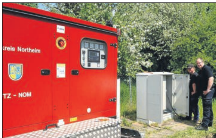
Stromversorgung: Steven Bomhauer (rechts), Leiter der FTZ Northeim, und Marcus Heiligenstadt, stellvertretender Wasserwart der Gemeinde, am Gillersheimer Hochbehälter. Foto: Weiss
